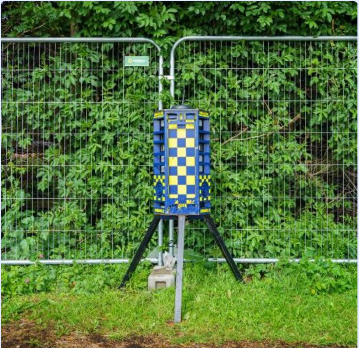
Perimeter-Einbruchmeldesystem – überwacht die Grundstücksgrenzen und alarmiert bei unbefugtem Zutritt.
